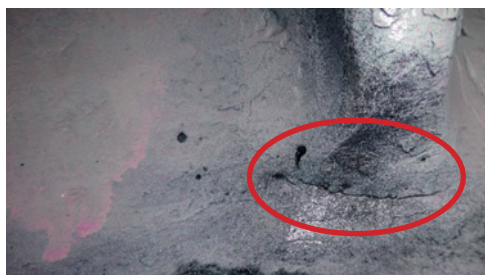
Rys. 8. Przykłady uszkodzeń kadłubów turbiny – błąd konstrukcyjny
